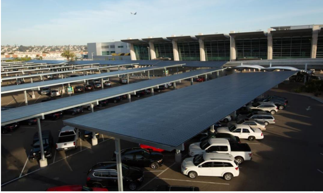
Görsel 2.2. San Diego Havalimanı otopark çatısına kurulu güneş enerji santrali ( http-3 )
