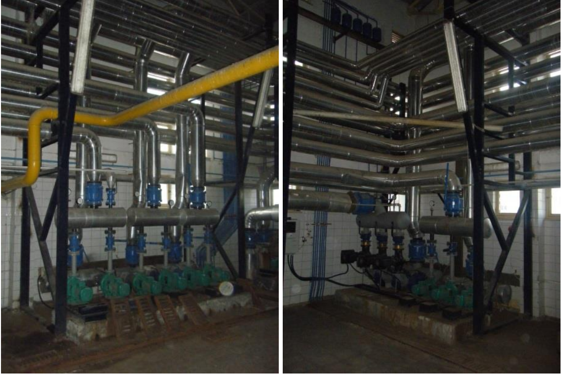
Şekil 3.16. Anadolu Üniversitesi İki Eylül Kampüsü'nde yer alan ısı merkezindeki sirkülasyon pompaları
