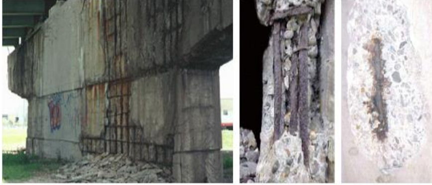
Görsel 3.4. Korozyonun yapılara etkileri [23].
