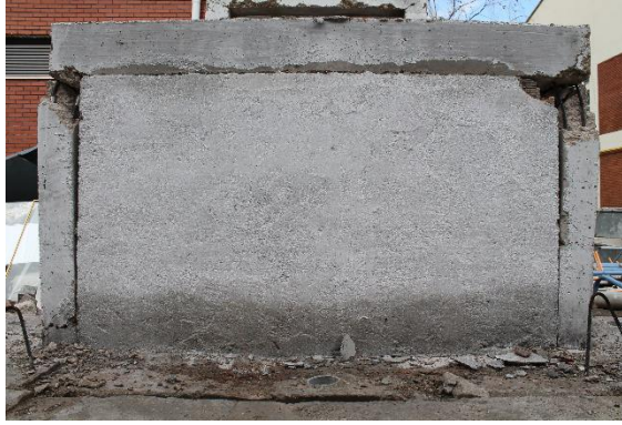
(c) Son çevrimdeki duvar hasarı
