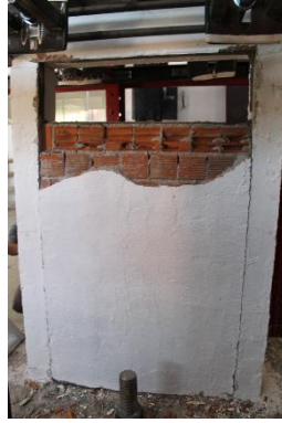
(c) Son çevrimdeki duvar hasarı
