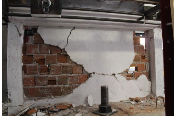
(c) Son çevrimdeki duvar hasarı
