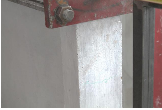
(a) Kolondaki ilk eğilme çatlak
