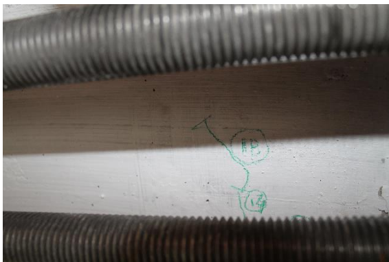
(a) Kirişteki ilk eğilme çatlakı
