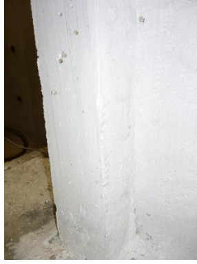
(a) Duvarda gözlenen ayrılma
