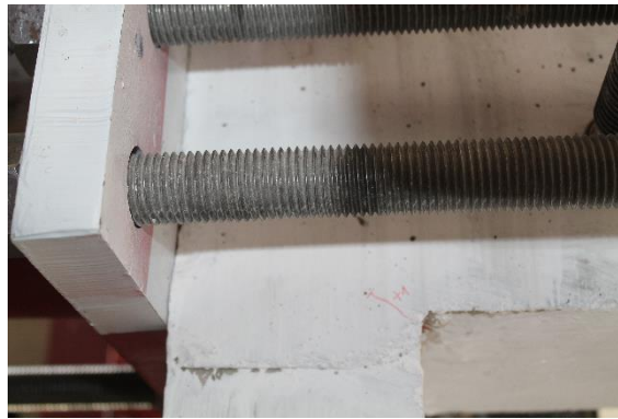
Birleşim bölgesindeki ilk çatlak
