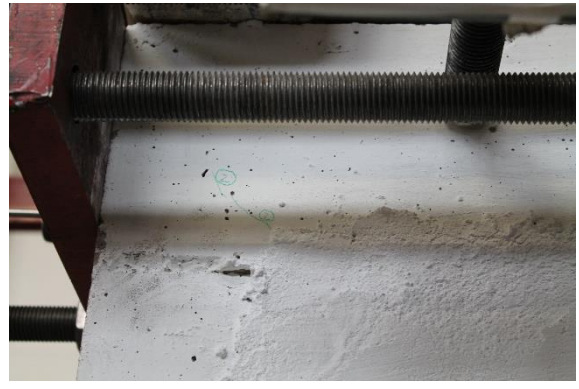
(b) Birleşim bölgesindeki ilk çatlak
