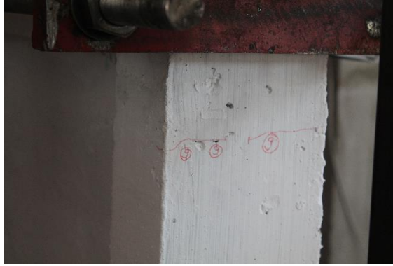
Görsel 4.21. IE06 numunesinde kolonlarda gözlenen ilk çatlak oluşumları
