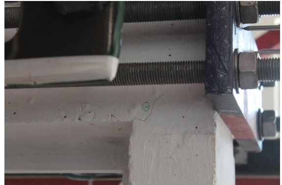
(b) Birleşim bölgesindeki ilk çatlak
