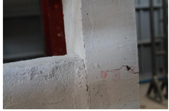
(b) Duvarda gözlenen ezilme
