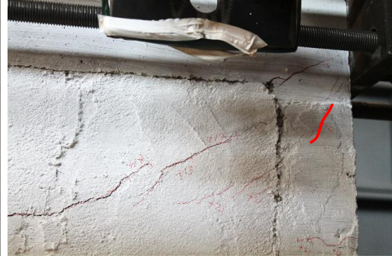
(b) Kolondaki ilk kesme çatlak
