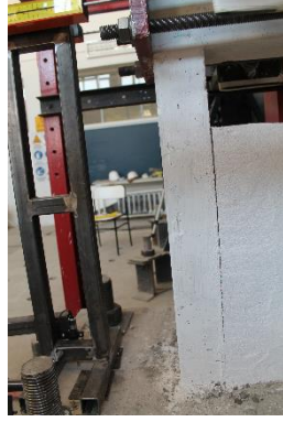
(a) Duvarda gözlenen ayrılma
