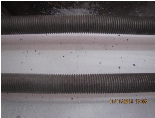
(a) Kirişteki ilk eğilme çatlağı
