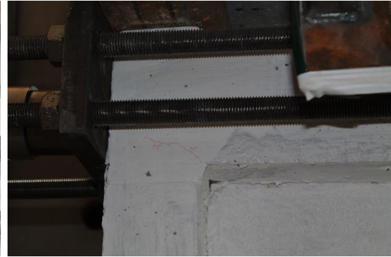
(b) Birleşim bölgesindeki ilk çatlak
