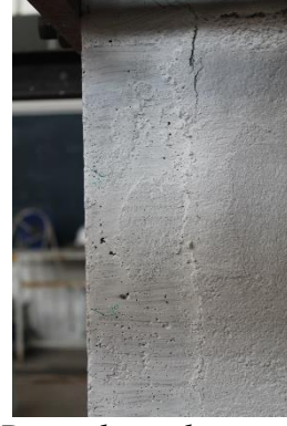
(b) Duvarda gözlenen ezilme
