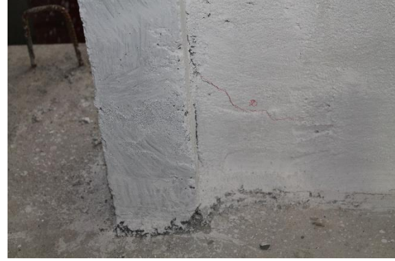
(b) Duvarda gözlenen dönmeye neden olabilecek hasar
