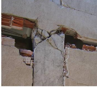
Görsel 2.3. Dolgu duvar hasarına bağlı kolon kesme hasarı
