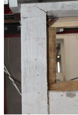
(b) Kolondaki ilk kesme çatlağı
