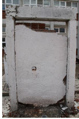
(c) Son çevrimdeki duvar hasarı
