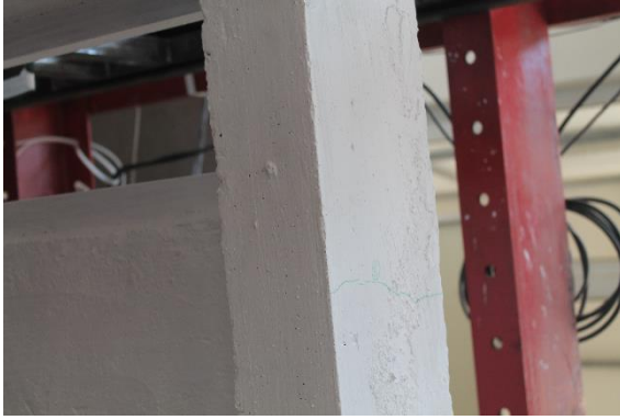
(a) Kolondaki ilk eğilme çatlağı
