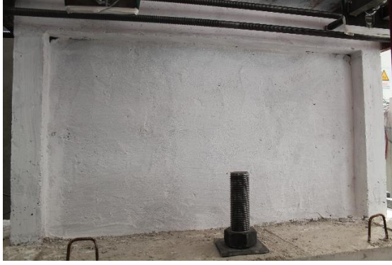
(a) Duvarda gözlenen ayrılma
