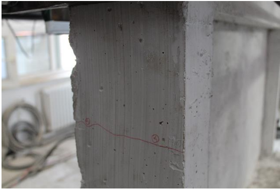
(a) Kolondaki ilk eğilme çatlağı
