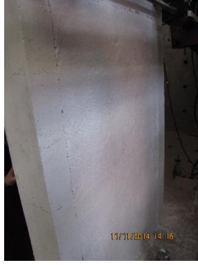
(a) Duvarda gözlenen ayrılma
