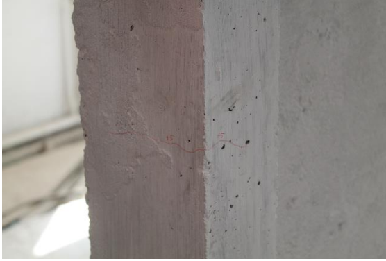
(a) Kolondaki ilk eğilme çatlak
