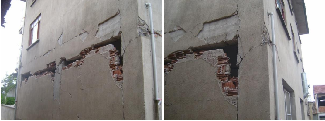
Görsel 2.15. Deprem sonrası gözlenen boşluksuz dolgu duvarlı çerçevede kısa kolon hasarı
