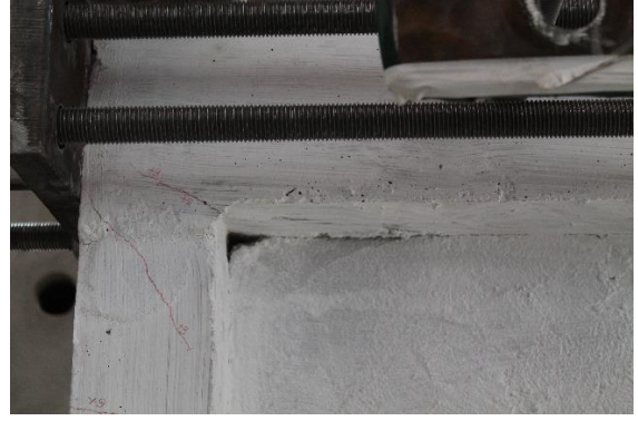
(b) Kolondaki ilk kesme çatlak
