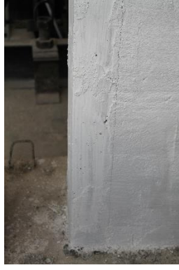
(a) Duvarda gözlenen ayrılma
