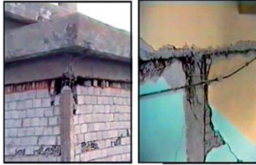
Görsel 2.9. Tam dolu dolgu duvarlı sistemde kolonlarda kesme hasarı
