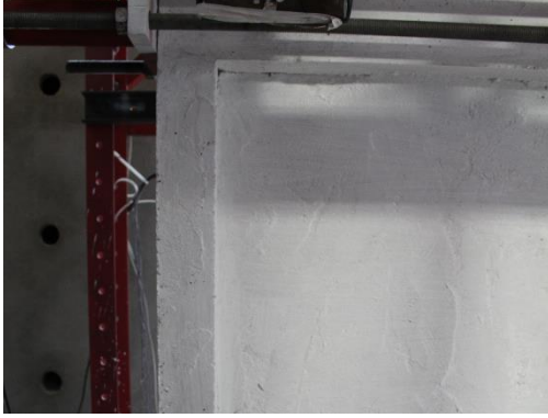
(a) Duvarda gözlenen ayrılma
