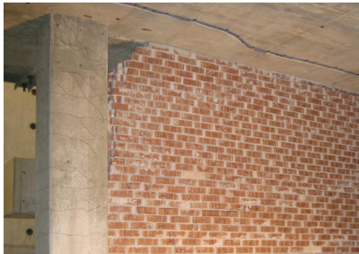
Görsel 2.14. Dolgu duvarda köşede oluşan hasara bağıli kesme çatlakları
