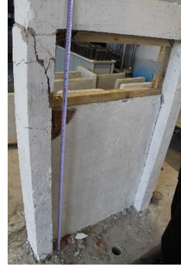
(d) Son çevrimdeki duvar hasarı
