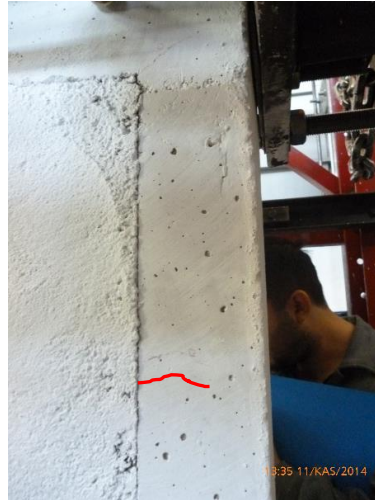
(a) Kolondaki ilk eğilme çatlağı
