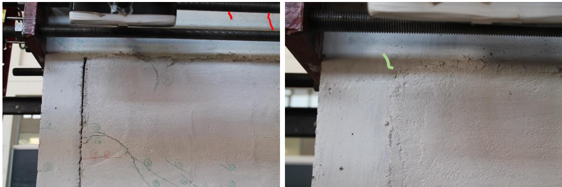
(a) Kirişteki ilk eğilme çatlağı
