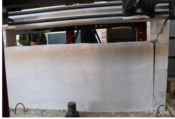
(c) Son çevrimdeki duvar hasarı
