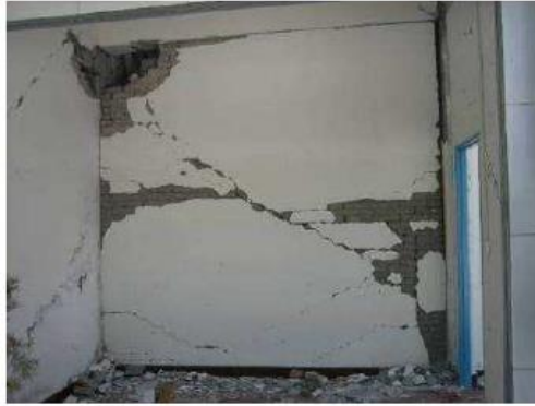
Görsel 2.6. Dolgu duvar hasarından sonra kolonda meydana gelen kesme hasarı
