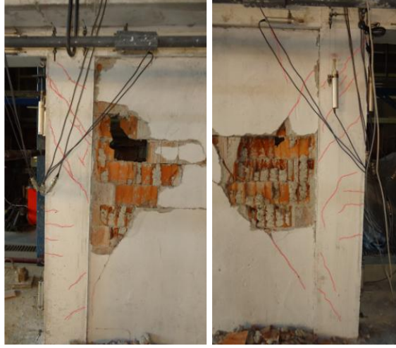
Görsel 2.11. İlk kattaki kolonlarda gözlenen kesme hasarları
