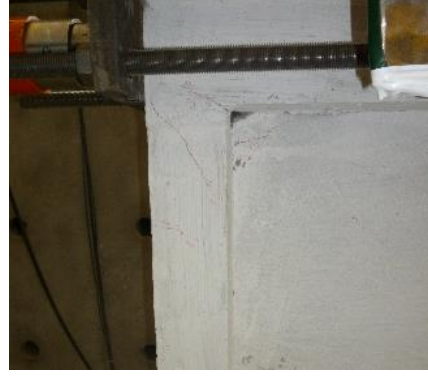
(b) Duvarda gözlenen ezilme
