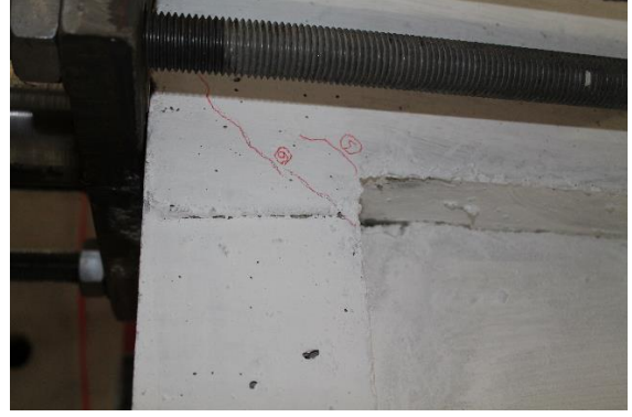
(b) Kolondaki ilk kesme çatlağı
