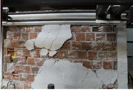
(c) Yıkılmadan önceki duvar hasarı
