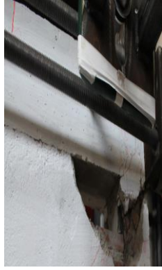
(a) Kirişteki ilk eğilme çatlağı
