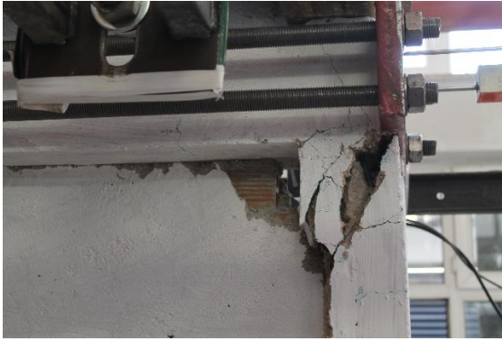
(a) Kirişteki ilk eğilme çatlak
