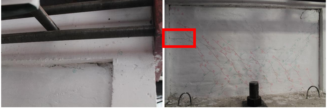
(a) Duvarda gözlenen ezilme
