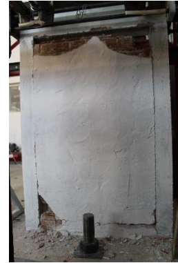
(d) Son çevrimdeki duvar hasarı
