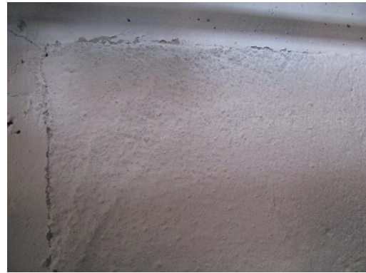
(b) Birleşim bölgesindeki ilk çatlak
