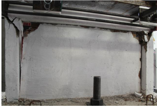
(c) Son çevrimdeki duvar hasarı
