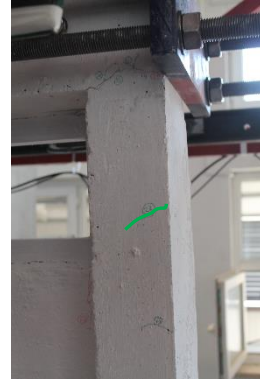
(b) Kolondaki ilk kesme çatlağı
