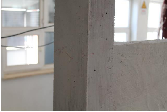
(a) Kolondaki ilk eğilme çatlağı
