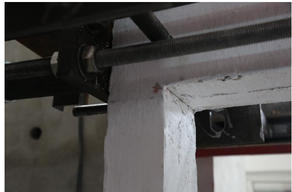
(b) Birleşim bölgesindeki ilk çatlak
