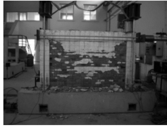
(b) Kilitli tuğla ile gözlenen hasar
