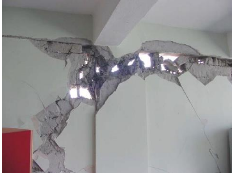
Görsel 2.4. Etrafı tam dolu dolgu duvar olan kolondaki kesme kırılması
