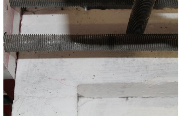
(b) Birleşim bölgesindeki ilk çatlak
