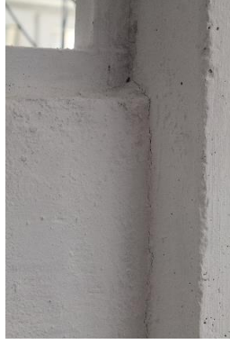
(a) Duvarda gözlenen ayrılma
