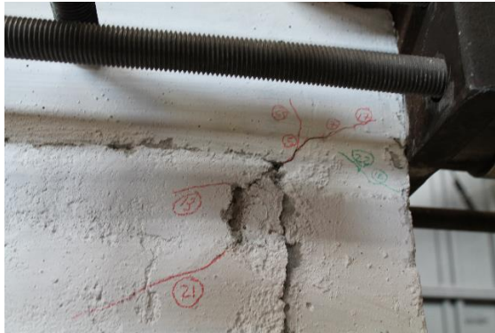
(a) Kirişteki ilk eğilme çatlağı
