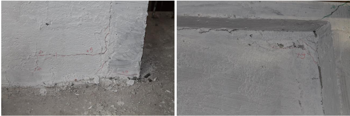
(a) Kolondaki ilk eğilme çatlađı
