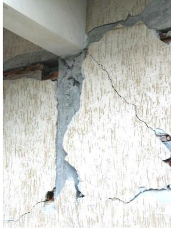
Görsel 2.5. Dolgu duvar hasarına bağlı kolondaki kesme hasarı
