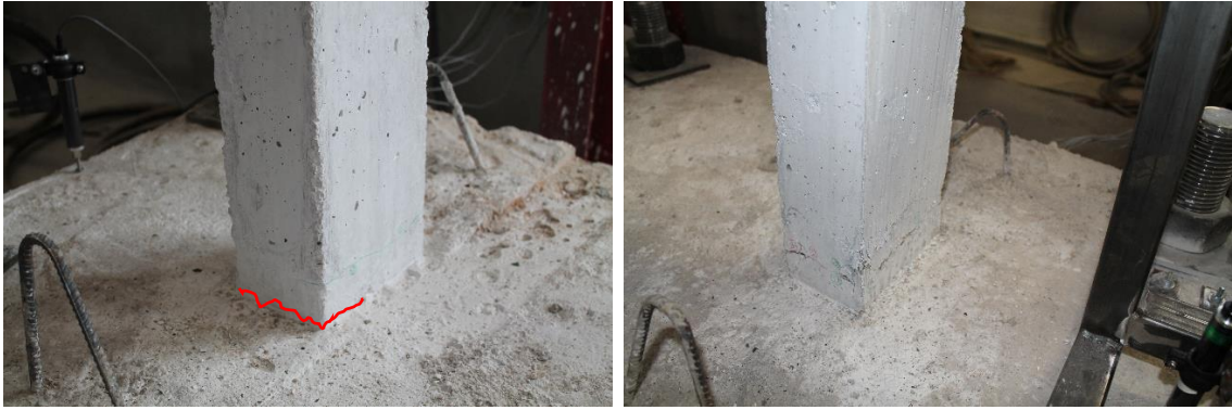
(a) Kolondaki ilk eğilme çatlağı
