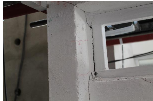
(b) Birleşim bölgesindeki ilk çatlak
