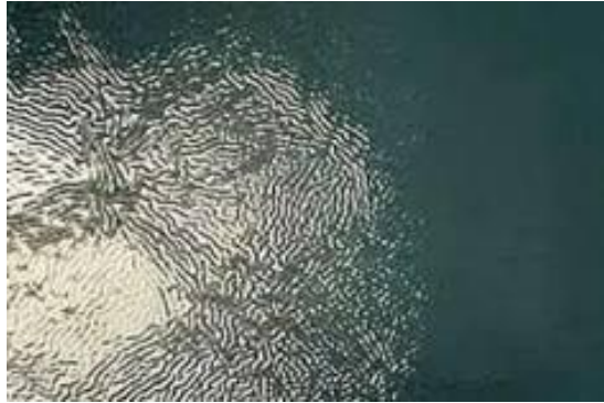
Şekil 2.8. Yüzeye uygulanmış boyadaki kırışma hatası görüntüsü [53].
