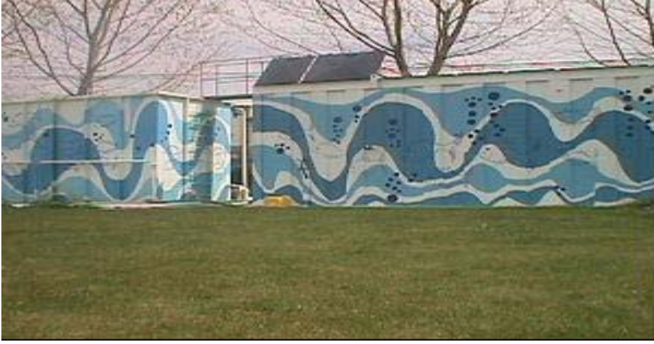
Şekil 3.6. Biyolojik Atıksu Arıtma Tesisi
