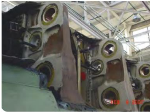
Görsel 3.12. F-18 uçağında korozyon (Rose and Legg, 2014)
