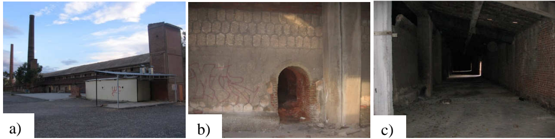
Şekil 17. a) Çiftkurt Kiremit Fabrikası kuzey cephesi ve tuvalet eklentisi, b) Çiftkurt Kiremit Fabrikası fırına giriş kemerli, c) Çiftkurt Kiremit Fabrikası kuzey cephesi tarafı iç mekan koridor görünümü [14].
