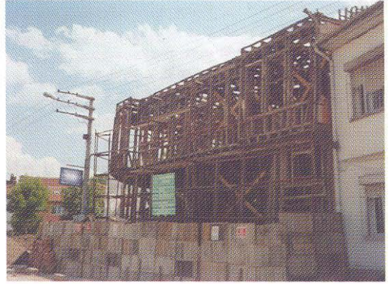
Restorasyon işlemi başlangıcında ahşap taşıyıcılar dışında kalan bina elemanları tamamen yıkılmış, çürüyen ahşap malzeme yenilenmiş, temel sistemi takviye edilmiş ve duvarlar tekrar yapılmıştır. Fotoğrafta; binanın ahşap iskelet halindeki görüntüsü.
